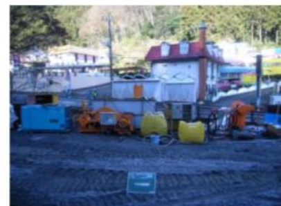
プラント設備
