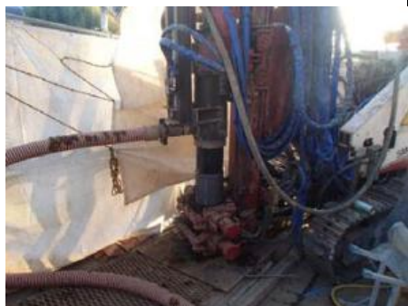
集塵・排土機能改善状況
