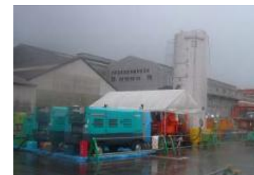
グラウトプラント
