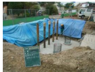
ヤットコ鋼管露出状況
