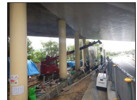
飛散防止フェンス
