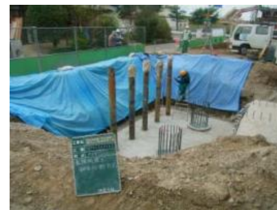
ヤットコ鋼管露出状況
