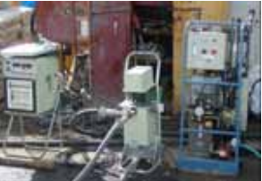
注入管理装置
