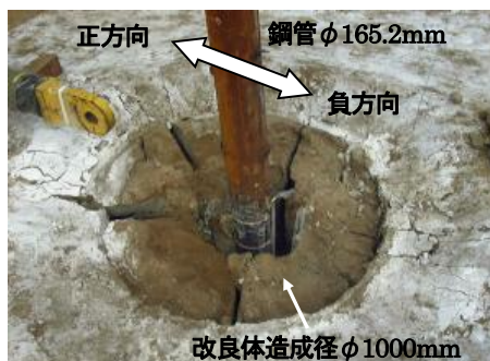
図-解 3.4.4 試験後の杭頭状況
